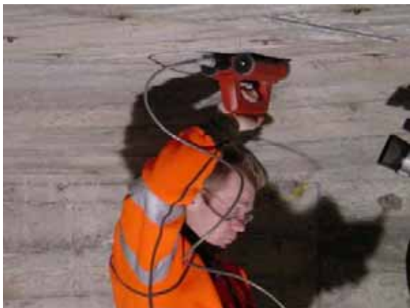
ill. 12: détermination de la position définitive des carottages (en raison de la disposition de l'armature)
