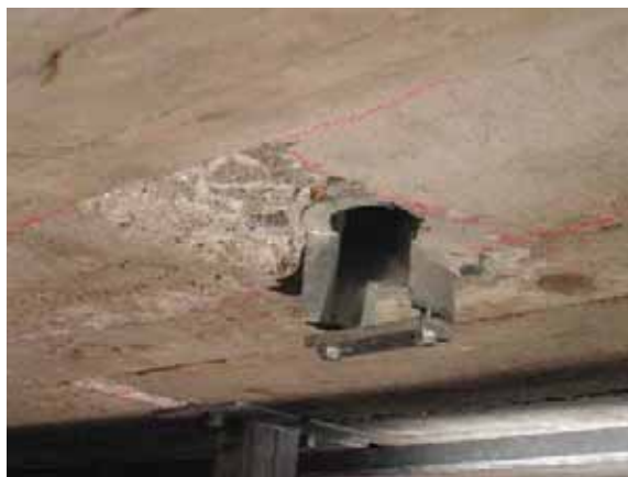
ill. 15: déplacement de l'ancrage fixe (type III)
