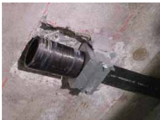
ill. 16: mise en place de l'ensemble de précontrainte dans l'ancrage fixe (type III)
